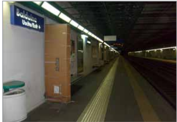
L'area binari: l'imballaggio in cartone visibile sulla sinistra cela la colonnina SOS in allestimento. Tutta la tratta Fr 3 ne è provvista
