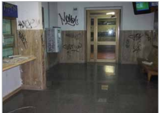
L'atrio della stazione: sono visibili scritte ed atti di vandalismo
