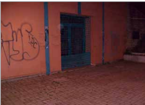
Nel piccolo cortile esterno di accesso, molto trascurato e imbrattato da scritte e rifiuti, si nota un locale in stato di abbandono, chiuso da una saracinesca
