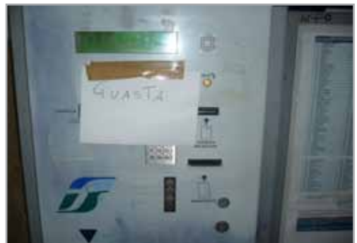
L'unica biglietteria automatica presente nella stazione risulta fuori uso
