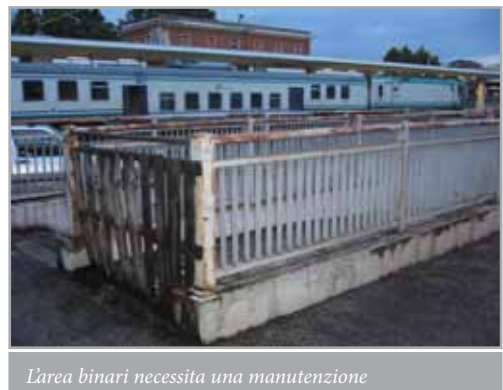
L'area binari necessita una manutenzione
