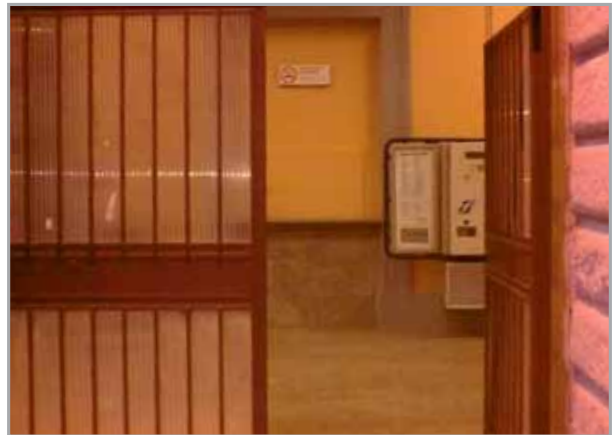
Il portone di accesso alla stazione non si chiude
