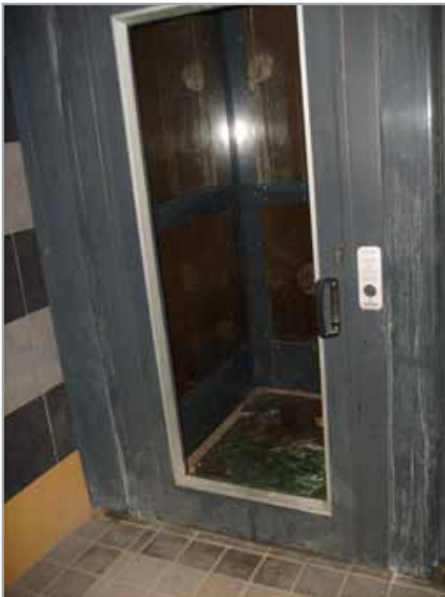
L'ascensore per disabili è stato recentemente danneggiato
