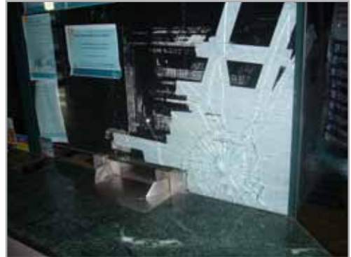
Segni di effrazione sul vetro della biglietteria
