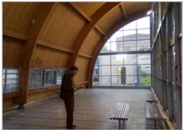
L'operatore HCM nell'edificio: probabilmente si tratta di una sala d'attesa per i passeggeri Cotral, ma è in pessime condizioni
