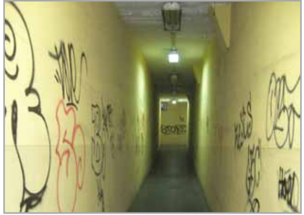
Anche il lungo corridoio che collega le due uscite, passando sotto la tangenziale, è poco illuminato
