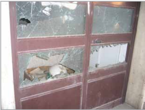
I locali della stazione che affacciano sul binario 1 sono danneggiati ed esposti alle intemperie
