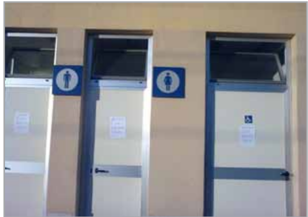
Un cartello posto sulla porta di accesso dei servizi igienici segnala che, dal 10 giugno 2010, essi sono inutilizzabili
